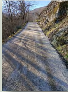
Réfection de la route aux Rivoirands, cote suster, en février. Grenoble Alpes Métropole
